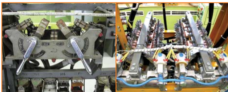
Rys. 1. Odłącznik OSTA-400 (z lewej) zastąpiony przez 2 odłączniki MAO-602/2
